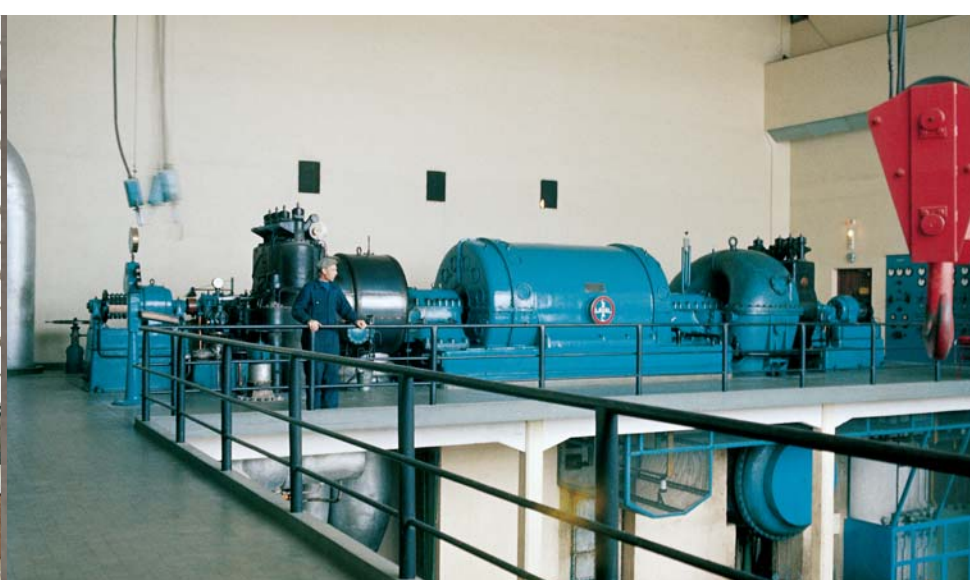
▲ The turbine hall. (Veli Autio.)
